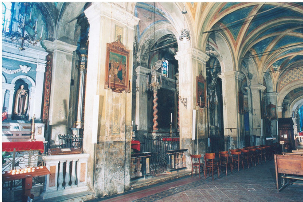
La navata settentrionale nel 1991, umidità per risalita, stacchi di intonaco, decorazioni sbiadite, pavimenti sollevati, recipienti nelle cappelle laterali per raccogliere l'acqua piovana
