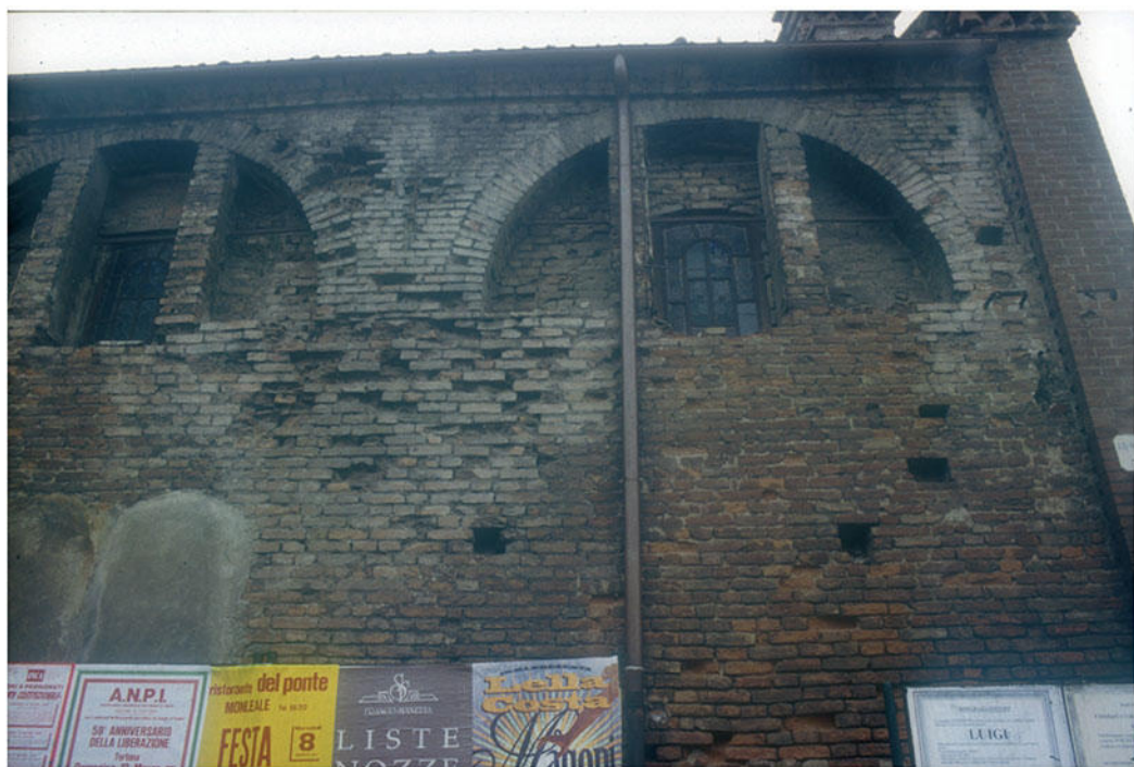
Le fiancate nord e sud nel 1993. Evidenti i segni di risalita di umidità e di corrosione dei mattoni. Adirittura in basso sulla destra, dove il tubo di alimentazione dell'ex vespasiano continuava a riversare acqua nelle fondamenta, l'umidità arrivava fin quasi al canale di gronda
